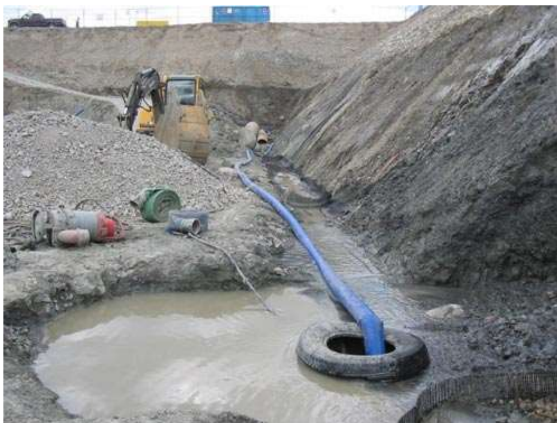
Рис. 2.7. Откачка воды из зумпфа с помощью стационарной насосной установки, расположенной на площадке уступа
