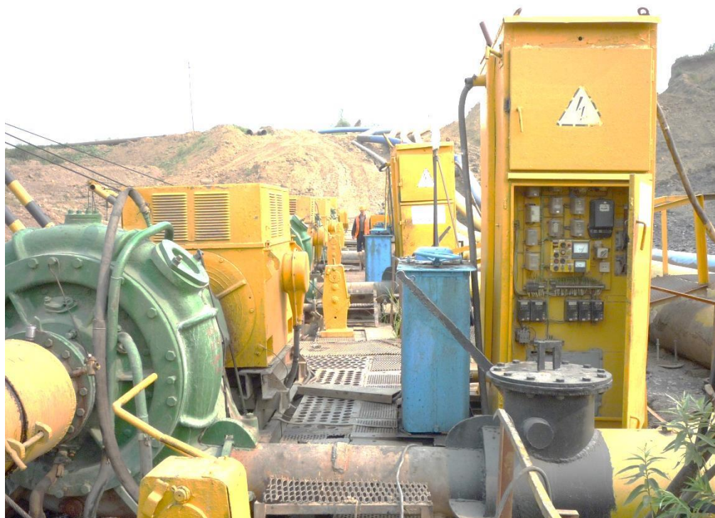
Рис. 6.1. Общий вид землесосного агрегата ЗГМ-2М
