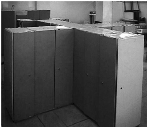
МКП Эльбрус-3-1 в машинном зале
