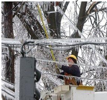
Рисунок 3 Сбивание льда с проводов
